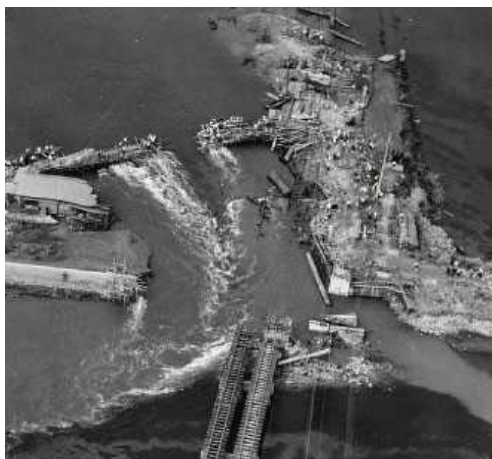
台風直後の大江川橋梁(大江~大同町) 1959(S34).9月下旬
