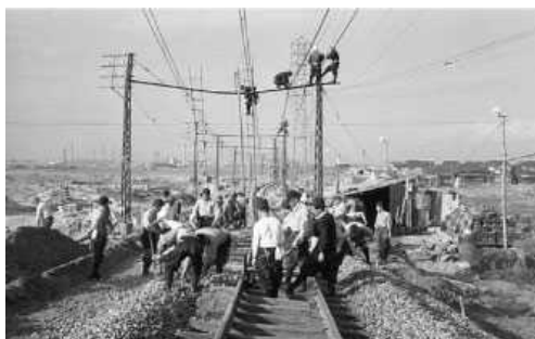
大江川橋梁付近の復旧工事(大江川橋梁の北側)。 大江～柴田は10/25に単線復旧した。
